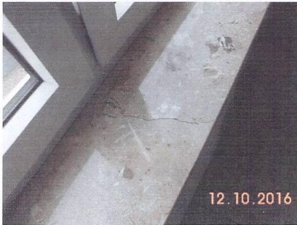
Rissbildungen im Treppenhaus - Haus-Nr. 35
