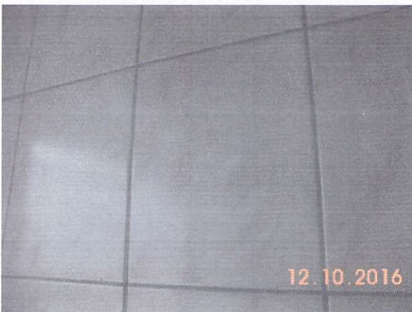
Schäden im Wandbereich - Gerissene Fliesen
