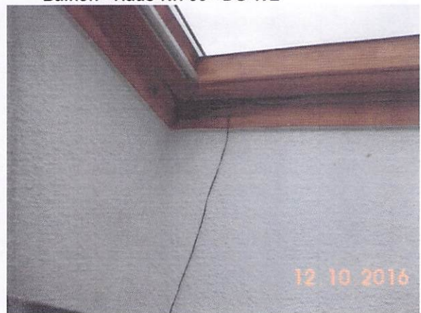
Feuchtschäden am Dachflächenfenster Haus-Nr. 35 - DG-WE
