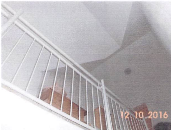
Einstiegluke - Haus-Nr. 35 - DG
