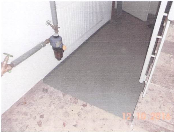
Hausanschluss Wasser - Haus-Nr. 33
