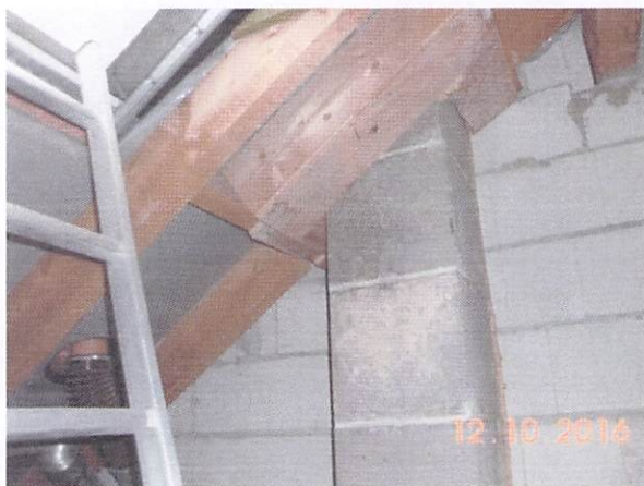
Schornsteinanlage - Haus-Nr. 35 - DG
