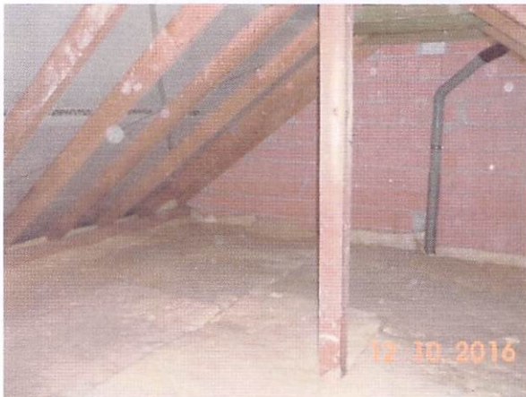
Einstiegluke - Haus-Nr. 35 - DG
